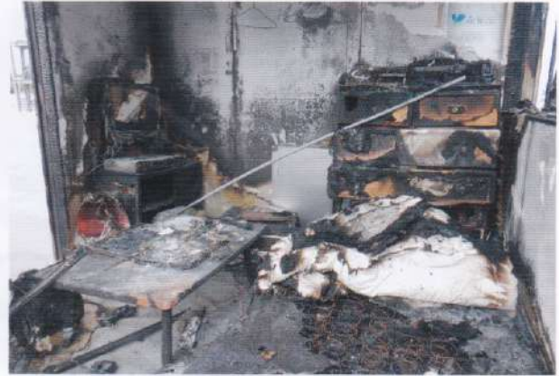
建物火災の現場から
